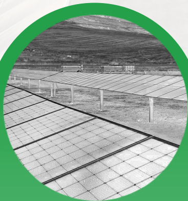
Estructura Seguimiento 1 eje
