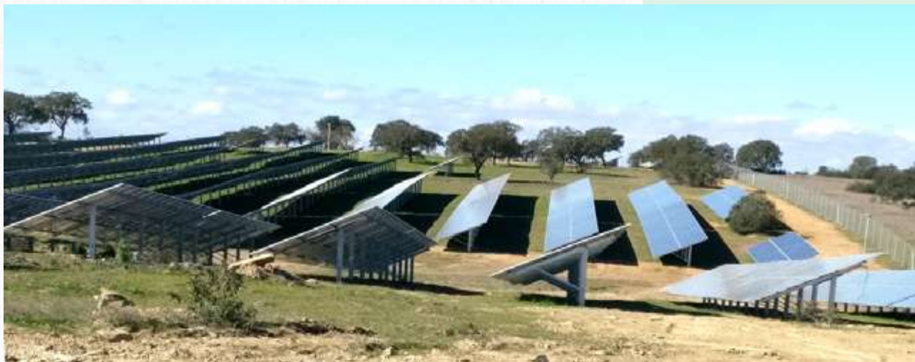
Estructura Hincada 2V Monoposte
