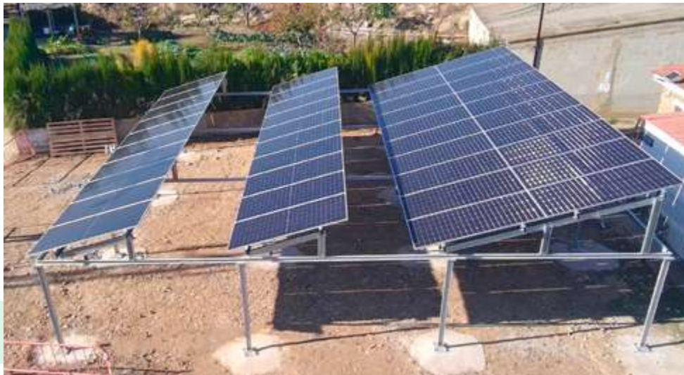
Estructura para Agrovoltaica
